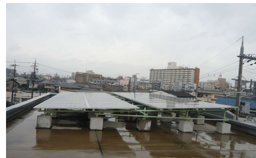
園の屋上10.5kWを2014年2月から売電中
